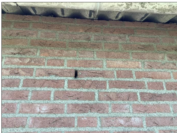
Foto 3 Open stootvoegen en open ruimte onder de golfplaten
