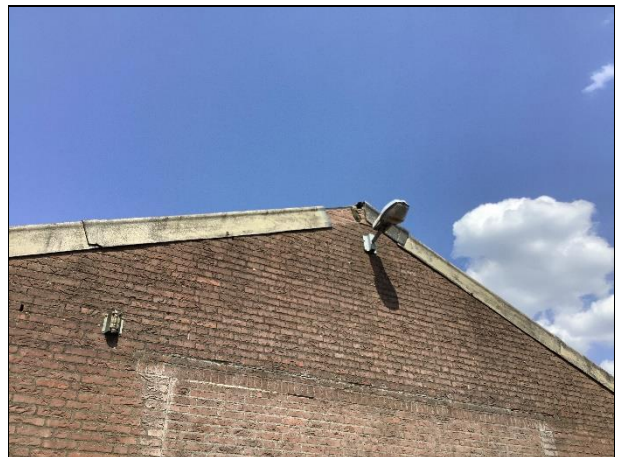
Foto 8 Beschadigde nokafwerking. Ook de hoekafwerking biedt ruimte als invliegopening.
