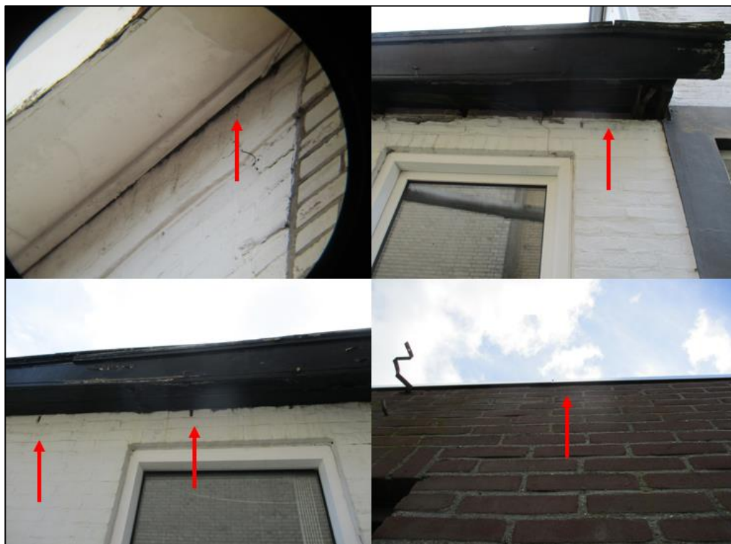
Figuur 4 Openingen onder het dakbeschoot en in stootvoegen welke vleermuizen toegang kunnen verlenen tot de bebouwing. De rode pijlen wijzen de openingen aan.
