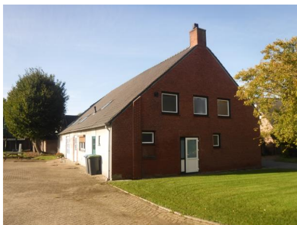
Woning: geen gaten, kieren en scheuren in gevels.
