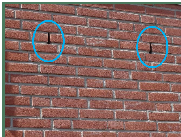
Open stootvoegen in de muur op de perceelsgrens van de burens
