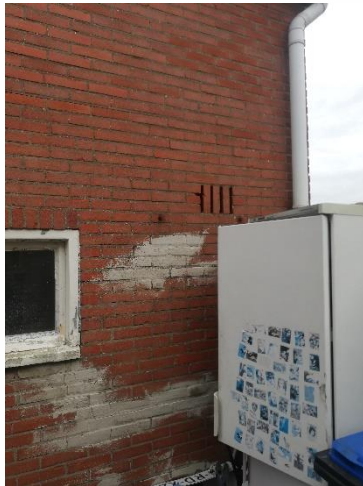
Figuur 4.4.1. De ventilatiesleuven worden geblokkeerd door een koelkast.
