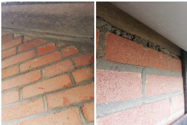
Figuur 4.4.2. De ruimte onder de golfplaten (links) is afgestroken met specie en ook de muurplaten (rechts) zijn in specie gelegd.
