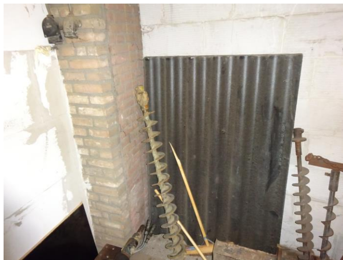
Losse golfplaten, niet asbestverdacht
