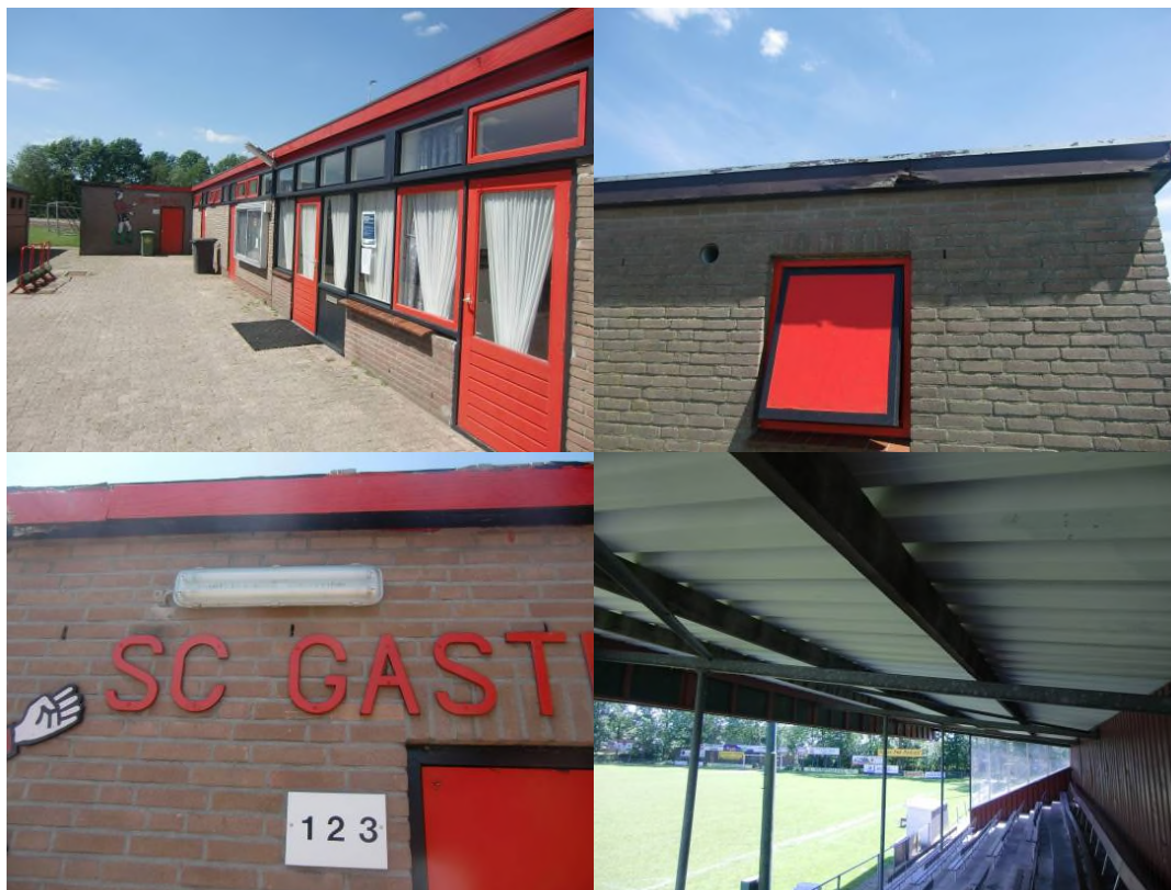
Afbeelding 5.2. Impressies bebouwing.. Linksboven, rechtsboven en linksonder een impressies van de bebouwing met aanwezig spouwmuurgaten en gaten in dakbeschoeiing. Linksonder een impressie van de aanwezige tribune.
