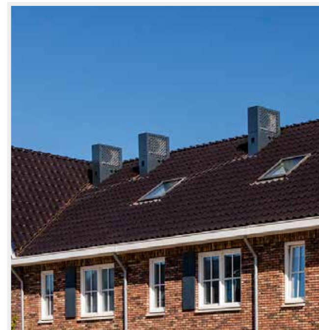
Rechts: zonnepanelen met een indak-systeem Boven: installatie ingepast in schoorsteen
