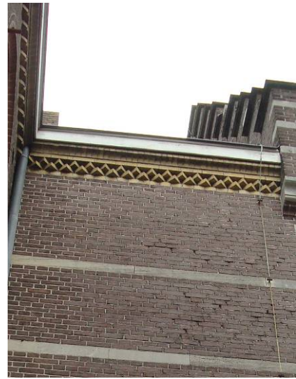
Afb. 34 Muizentandlijst onder de dakgoot van de voorgevel.
