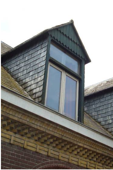
Afb. 32 Muizentandlijst onder de dakgoot van de noordgevel.
