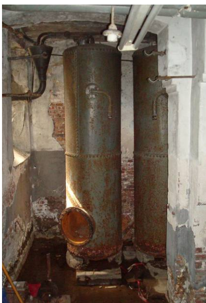
Afb. 183 Relicten uit het verleden: in onbruik geraakte (druk)ketels in de kelder.
