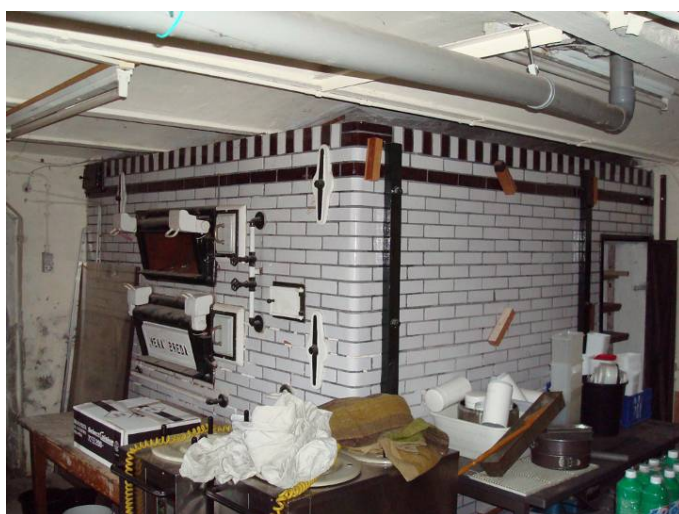
Afb. 191 De bakoven in de voormalige bakkerij in de kelder, geleverd door de firma "Beka" in Breda en geïnstalleerd in 1927.
