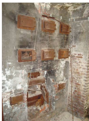
Afb. 192 Zwartgeblakerde achterzijde van de bakoven met gecorrodeerde deurtjes.
