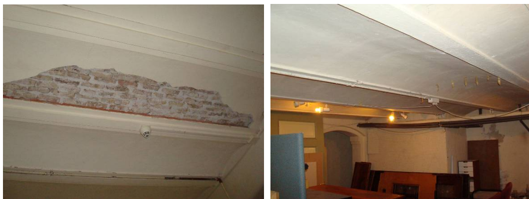
Afb. 119 Links: detailopname van een beschadigd gewelf in een gang van de noordvleugel. Zichtbaar is het metselwerk onder de pleisterlaag. Afb. 120 Rechts: Pruisische kappen in de voormalige bierkelder.
