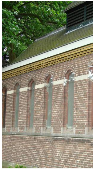
Afb. 33 Muizentandlijst onder de dakgoot van het zuidelijke toiletblok.
