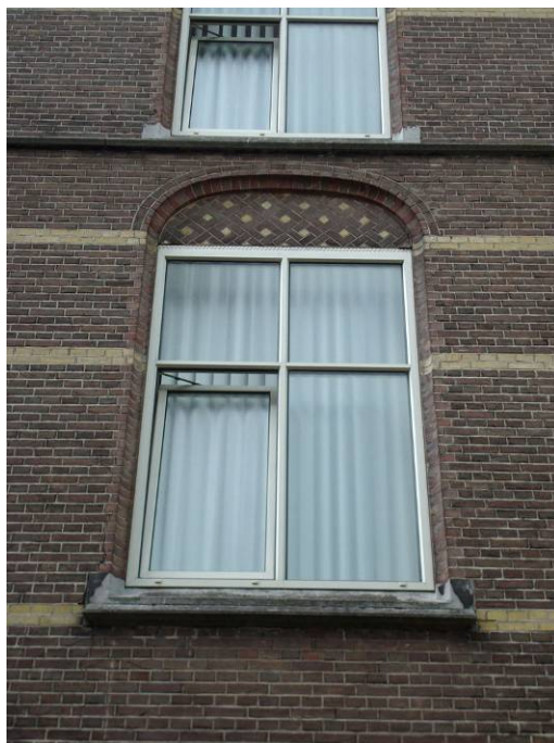
Afb. 167 Kunststof kozijn op de eerste verdieping van de noordvleugel (hofgevel). Het kozijn is veel te ijl en mist een roedeverdeling.
