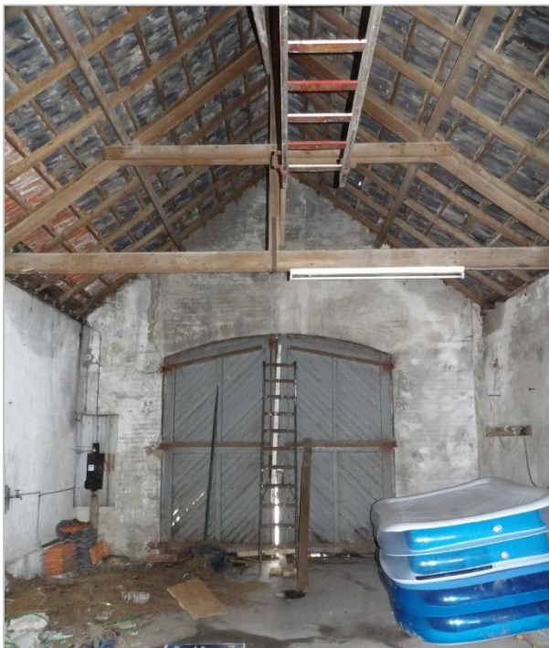
Foto 17: Garaga A openingen bij deur
