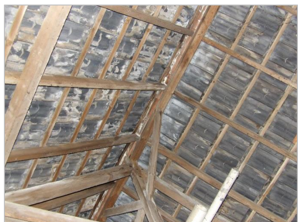
Foto 24: Dak garage B (pannen)
