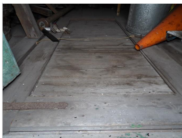
Foto 16: Stoflaag zolderruimte garage B
