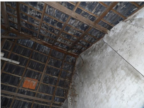
Foto 19: Dakpannen garage A (gaten)
