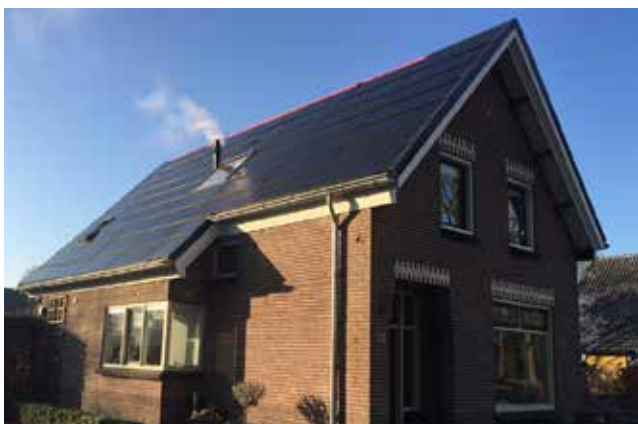
Zonnepanelen bij voorkeur geïntegreerd in het dakvlak
