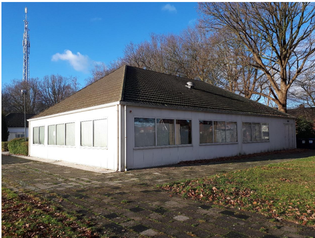
Figuur 11. Het oostelijke gebouw met boeiborden en dakpannen. Dit gebouw heeft geen spouw en de pannen liggen te strak om tussen te kunnen kruipen.
