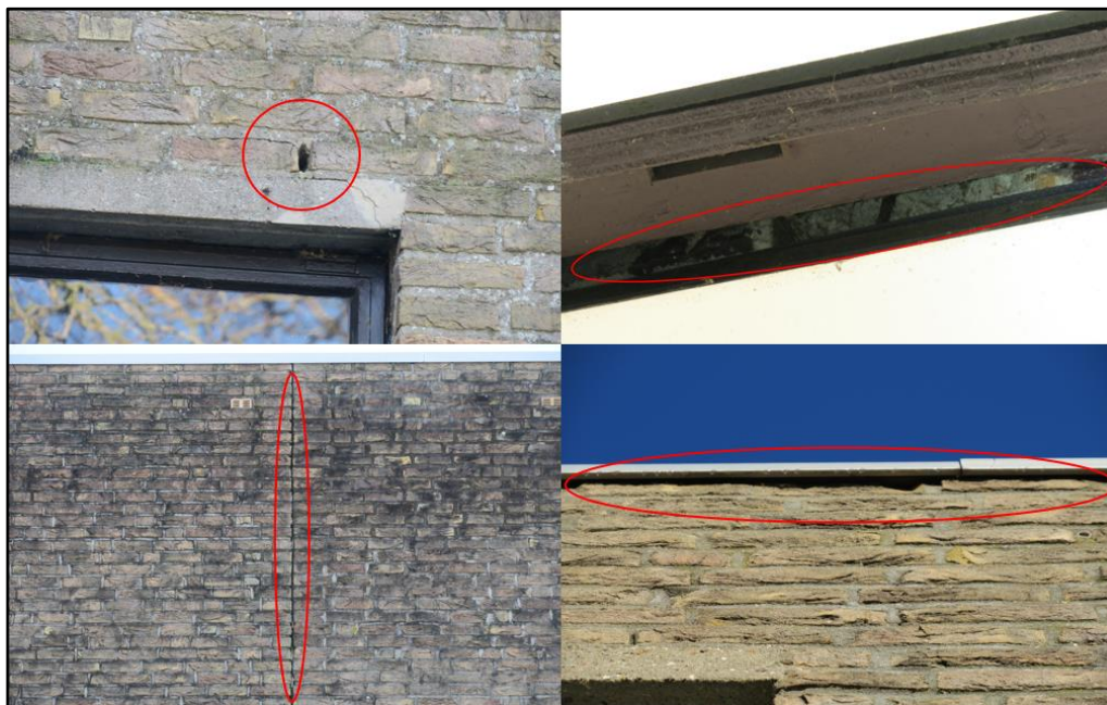
Figuur 4 Overzicht van een stootvoeg, kier onder de bovenzijde van een kozijn, kierende daklijst en dilatatievoeg waardoor vleermuizen toegang hebben tot de luchtspouw (en potentiële verblijfplaatsen) in de bebouwing.
