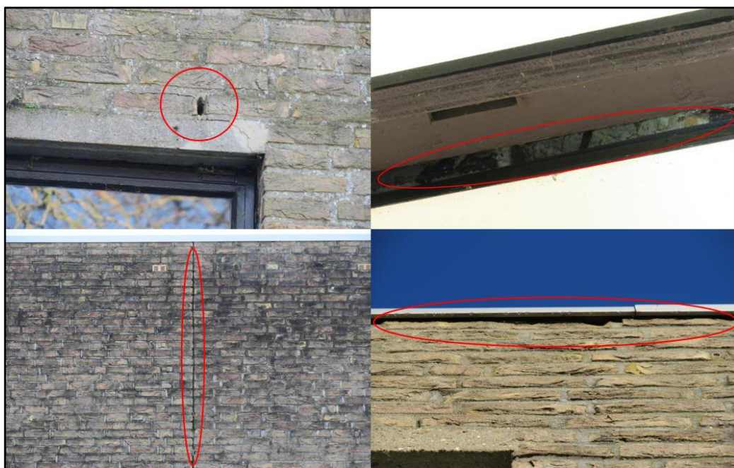
Figuur 1.3 Overzicht van een stootvoeg, kier onder de bovenzijde van een kozijn, kierende daklijst en dilatatievoeg waardoor vleermuizen toegang hebben tot de luchtpouw (en potentiële verblijfplaatsen) in de bebouwing.
