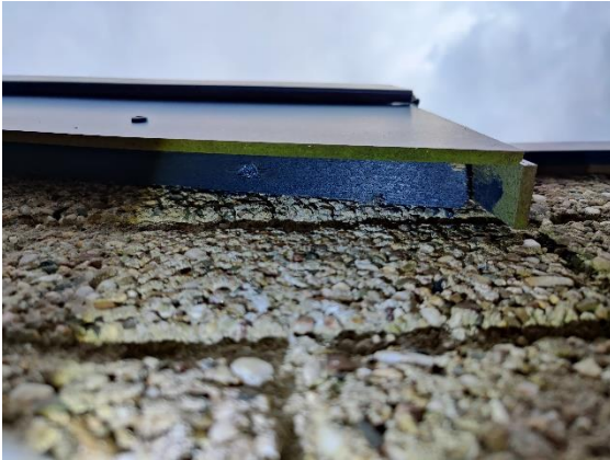
01: Lat aanhechting tussen de muur en de boeiboord kent geen speelt die breed genoeg is. De boeiboord steekt slechts 2 centimeter uit aan de onderzijde.
