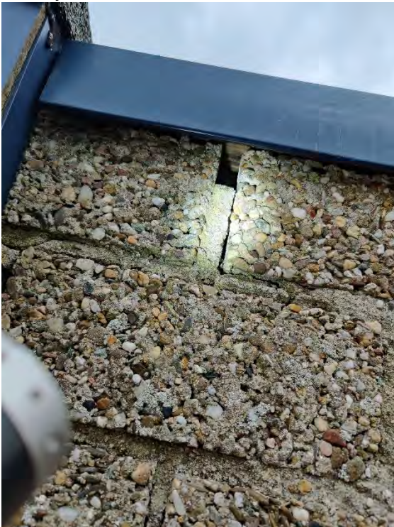
02: Enige plaats waar het voegwerk weg is waar ook ogenschijnlijk geen mortel zit. Op de volgende foto is te zien dat deze wel degelijk aanwezig is.
