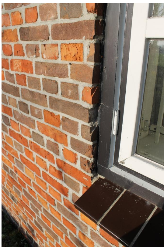
Detail metselwerk negge met zaagschade
