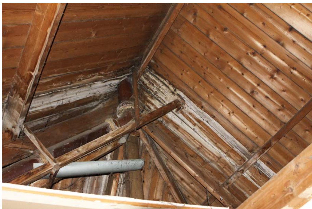
Zicht op het dak van binnen uit. Niet geïsoleerd en tochtig door de vele kieren. Oude lekkage en dus ook vochtig!
