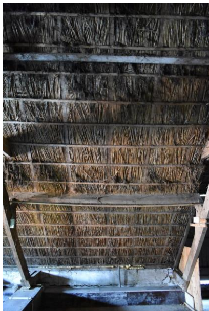
Riet onder dakpannen.
