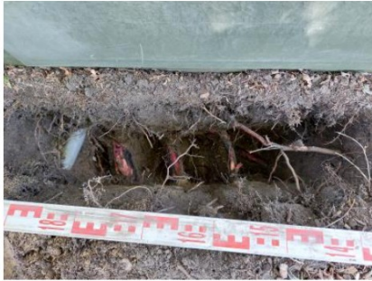
Afbeelding 5: intensieve beworteling onder de betonnen plaat van het transformatorhuisje
