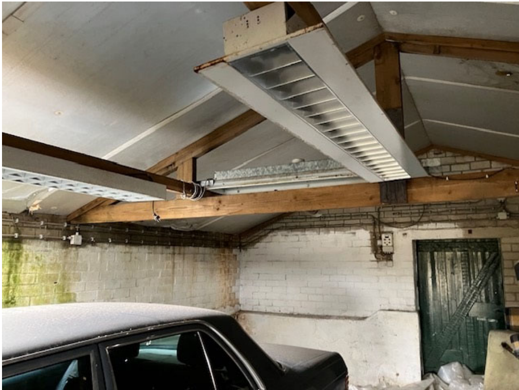
• Afbeelding 12: Te slopen gedeelte. Veel vochtsporen door het ontbreken van dak
