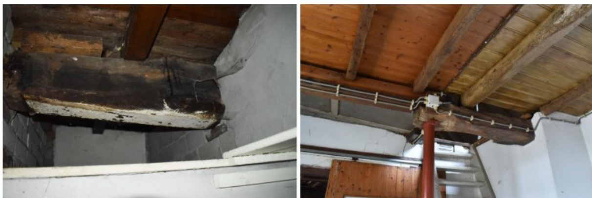
Figuur 17. De grote onderslagbalken van de balklaag op de begane grond aan de noordzijde waar de oorspronkelijke muur vervangen is door een kalkzand stenen exemplaar (linker foto, rode pijl) of een ijzeren stijl (rechterfoto).
