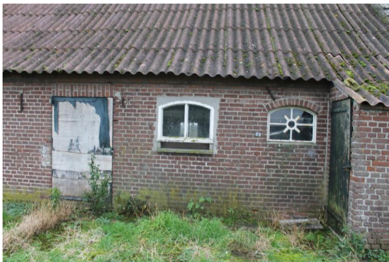
Oorspronkelijke deursparing, inboetwerk rondom venster en oorspronkelijk gietijzeren venster
