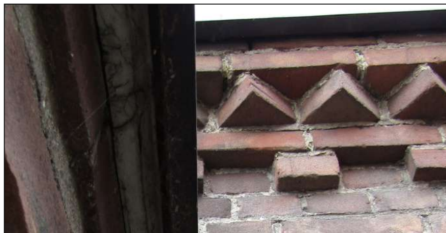
Figuur: onder de dakrand aan de zuidkant van de dansschool zit wel ruimte. Echter is deze ruimte te breed, wat het tochtig maakt en zodoende ongeschikt voor vleermuizen om tussen te kruipen.
