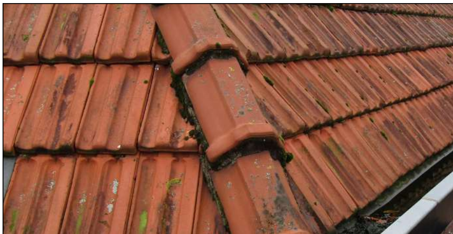
Figuur: de direct aangrenzende woning hebben dakpannen met een naar onderbuigende rand. Dit maakt de daken ongeschikt voor vleermuizen en huismussen.
