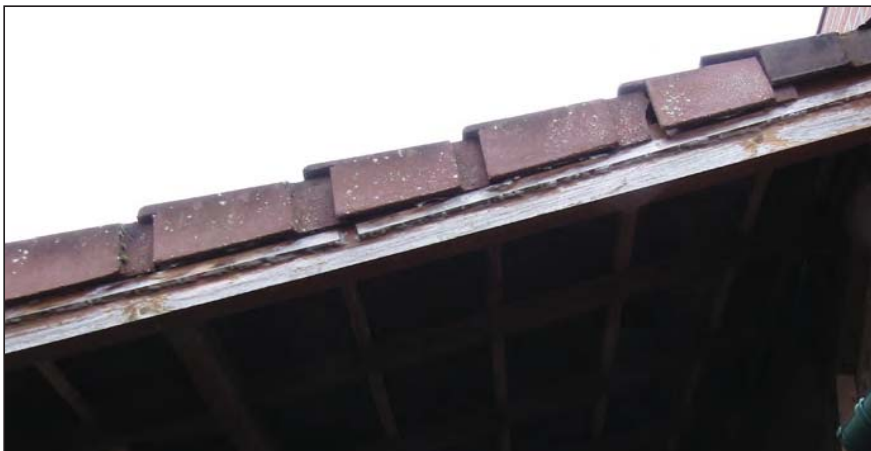
Figuur: de uitbouw is ongeschikt voor vleermuizen, omdat er tussen de overlappende rand en dakpannen tocht kan ontstaan. Dit aangezien de dakpannen enkel op houten balken liggen.
