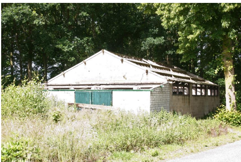
Figuur 4.1.4. Het tweede vervallen bijgebouwtje (3 in figuur 4.1.1).
