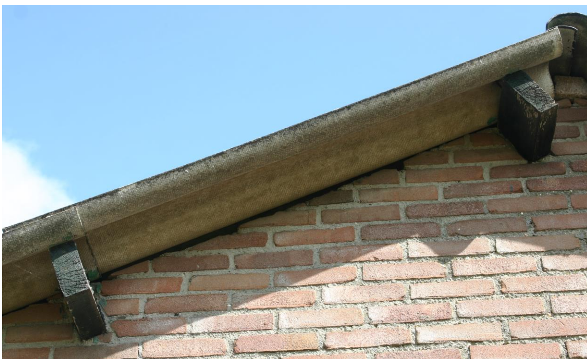
Figuur 4.2.2. Op de kopse kanten van de varkensstallen zitten grote openingen tussen de gevel en de golfplaten. Ook bij de nokken zijn diverse openingen aanwezig.
