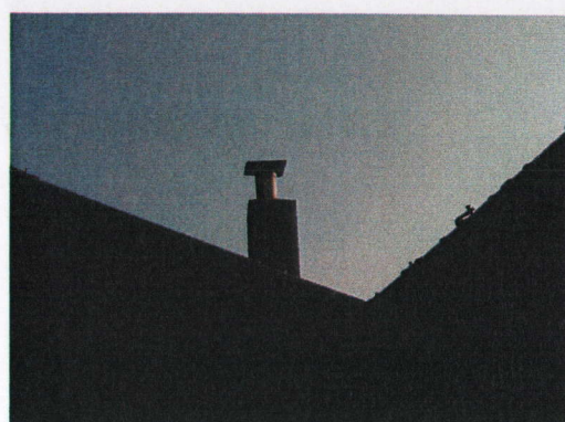
Foto 16. Rookkanaal CV-ruimte sluis 3
