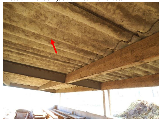
Foto 02: Onderzijde dak afdak varkensstal
