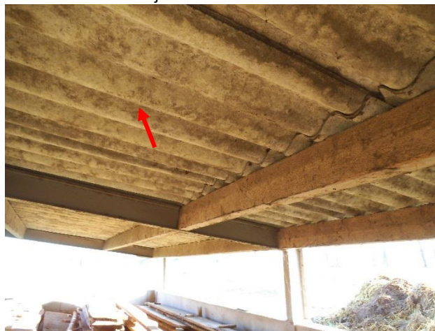
Foto 02: Onderzijde dak afdak varkensstal
