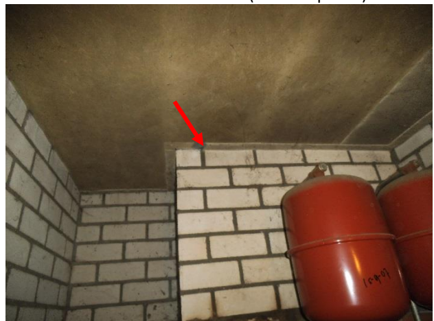
Foto 04: Plafond in cv-ruimte (monsterplaats)
