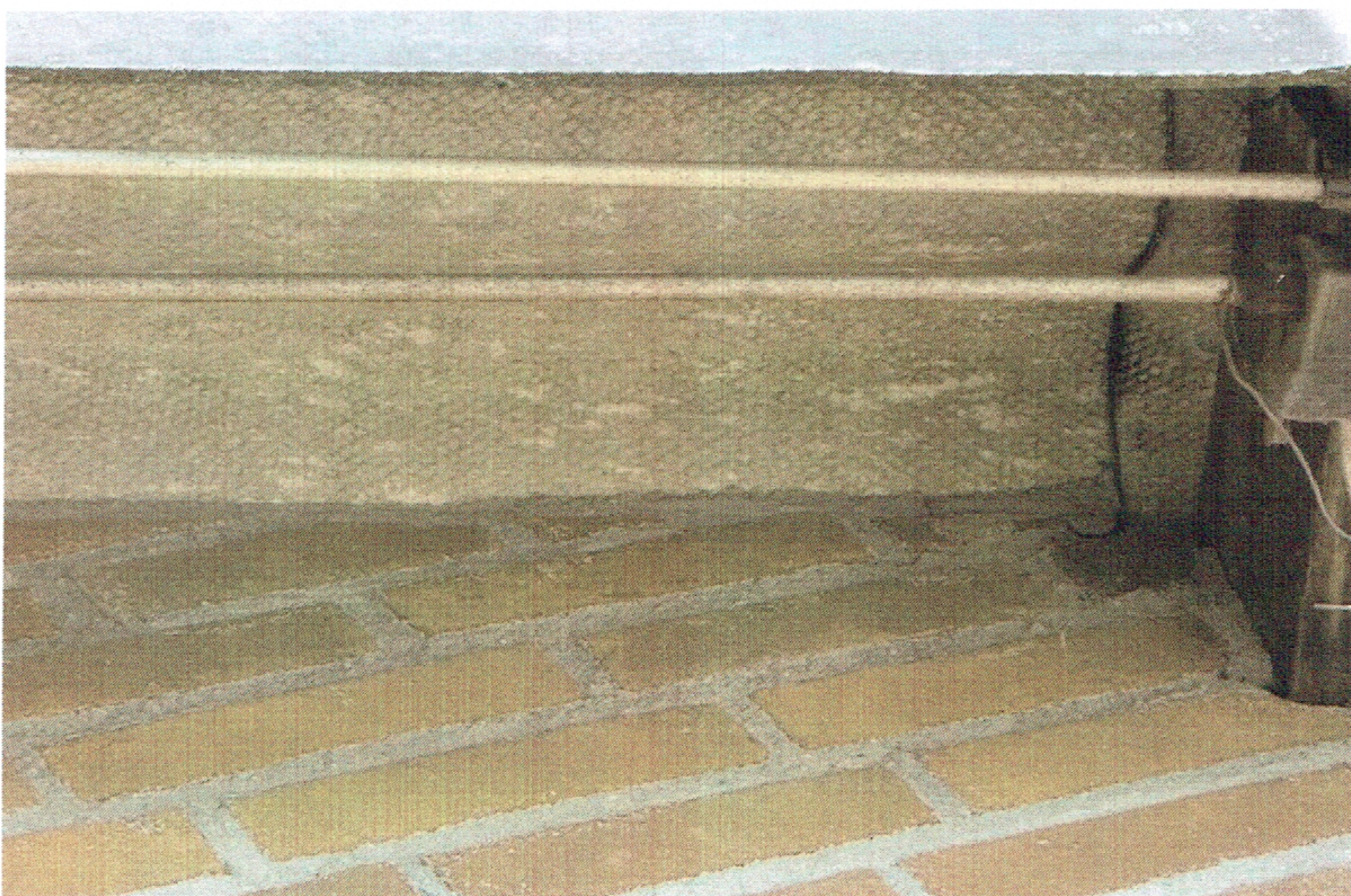
Afbeelding 6: Overgang golfplaten naar muur, dichtgesmeerd met cement. Bron: [REDACTED] 13-05-2020
