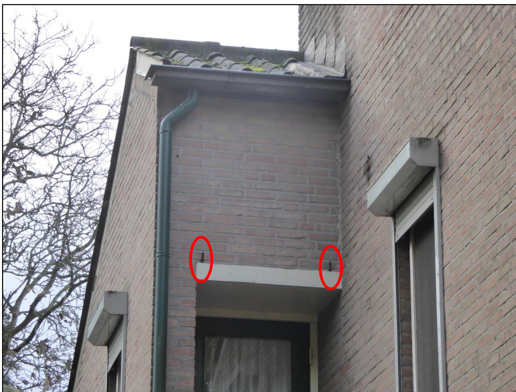
Open stootvoegen bij de bedrijfswoning.
