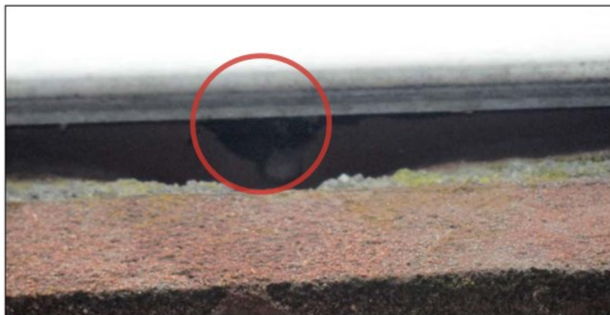
Figuur: onder de dakrand van de garageboxen in plangebied B is ruimte aanwezig doordat het voegsel deels afgebrokkeld is. Hier kunnen vleermuizen inkruipen en verblijfplaatsen hebben.
