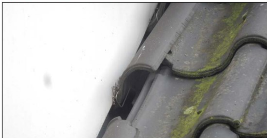
Figuur: er is ruimte aanwezig onder een dakpan in plangebied A waar huismus en gierzwaluw kunnen nestelen. Ook kunnen vleermuizen hier invliegen en verblijfplaatsen hebben in het dak.
