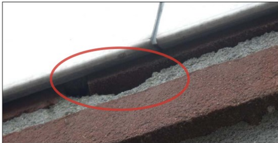
Figuur: onder de dakrand van het autobedrijf in plangebied A is ruimte aanwezig doordat het voegsel deels afgebrokkeld is. Hier kunnen vleermuizen inkruipen en verblijfplaatsen hebben.
