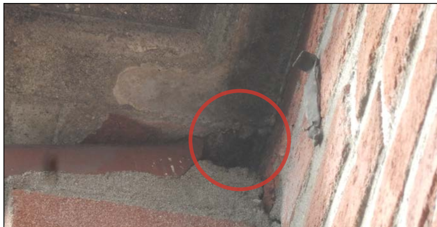
Figuur: in de oostgevel van het pension in plangebied A is een opening aanwezig in de muur waar vleermuizen kunnen inkruipen en verblijfplaatsen kunnen hebben in de spouwmuur.
