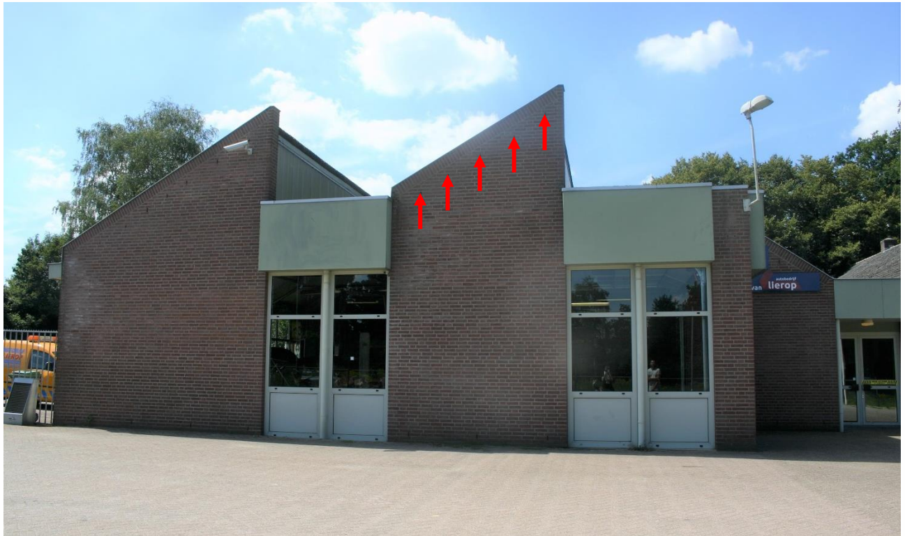
Figuur 4.4.2. In de spouw van de garage bevinden zich meerdere open stootvoegen of verschillende hoogtes (hier op een gedeelte van de gevel weergegeven met rode pijlen).
