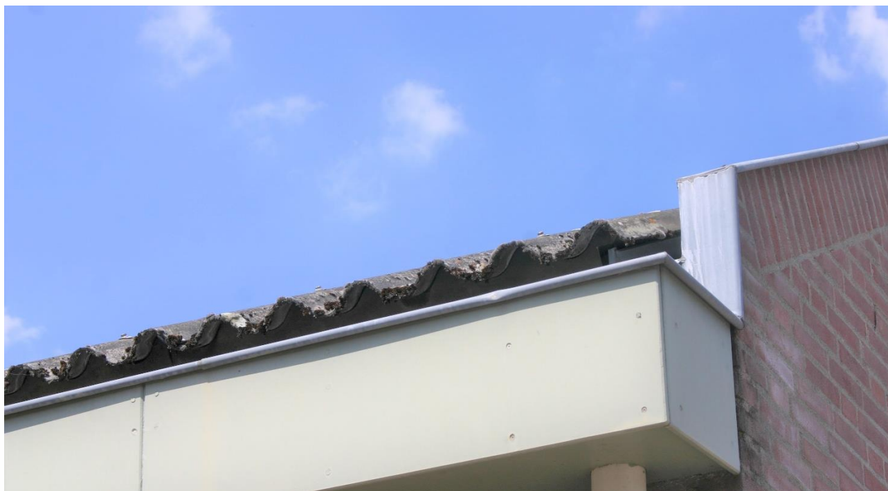
Figuur 4.4.5. De ruimte onder het golfplaten dak van de garage is afgedicht met vogelschroot en de kopgevel is hoog opgemetseld. Hierdoor is dit gebouw ongeschikt voor zowel huismus- als gierzwaluwnesten.
