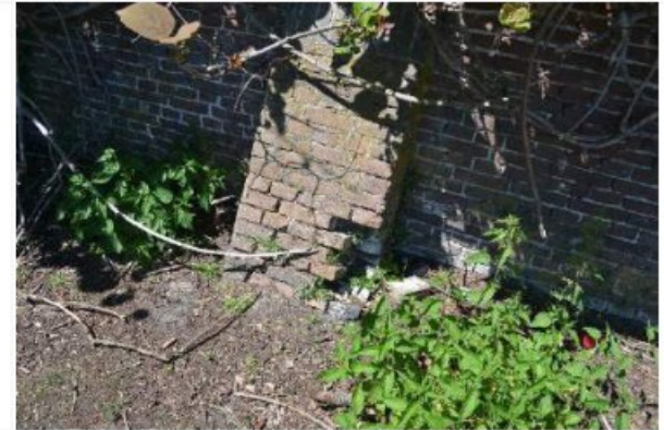
Slechte staat metselwerk van steunberen
