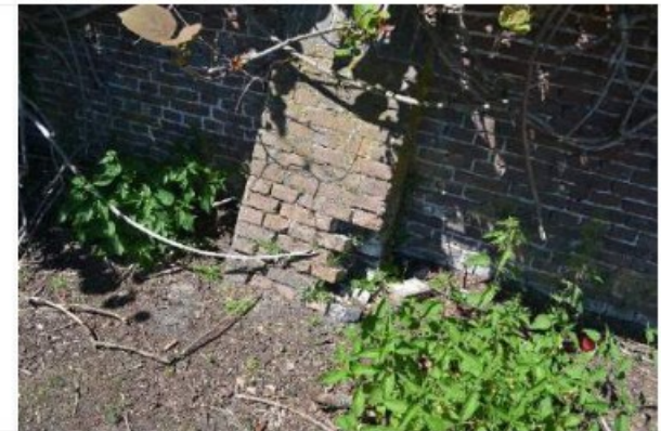
Slechte staat metselwerk van steunberen
