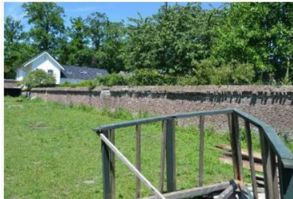
Ontbrekende/afgebroken metselwerk van ezelsruggen
