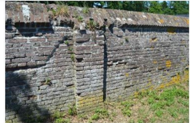
Metselwerk plaatselijk zeer slecht
