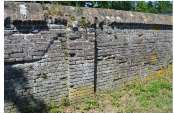
Metselwerk plaatselijk zeer slecht
