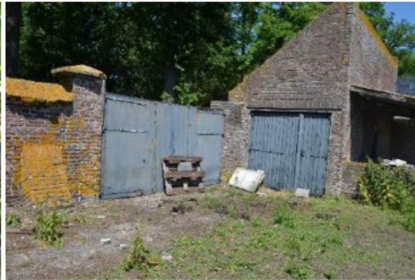
Ontbreken afdekplaat op pijler
