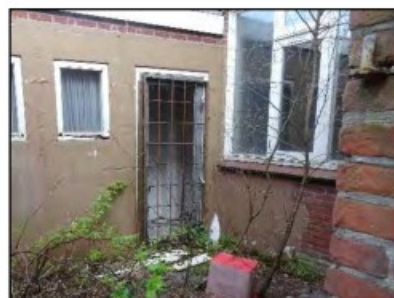
Figuur 25. De deur ontbreekt. Door het hek wat hiervoor geplaatst is kan de steenmarter naar binnen.
