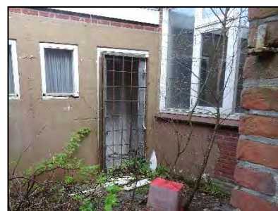
Figuur 25. De deur ontbreekt. Door het hek wat hiervoor geplaatst is kan de steenmarter naar binnen.
