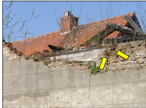
Figuur 18. Openingen in de muren van het afgebrande huis.
