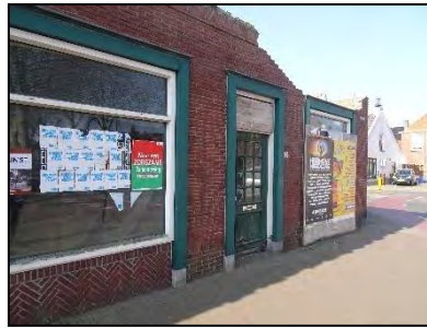
Figuur 5. Afgebrande woning (4), gezien vanaf de Haageijk.
