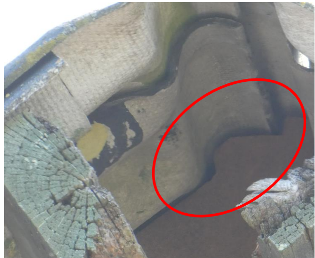
Afbeelding 15. Eén van de locaties met gaten, kieren en/of spleten (rode markering) aan de kopse kant van een gebouw.
