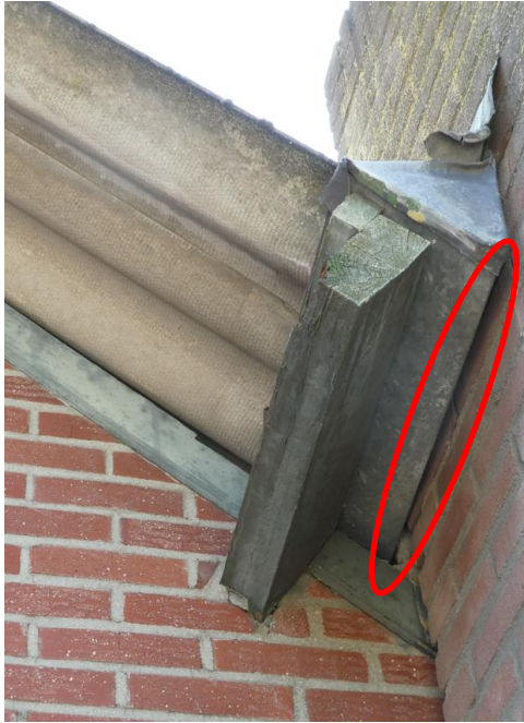
Afbeelding 16. Één van de locaties met gaten, kieren en/of spleten (rode markering) tussen de overgang van het gebouw en de schoorsteen.
