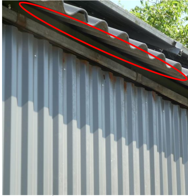
Afbeelding 17. Één van de locaties met gaten, kieren en/of spleten (rode markering) onder het dak van het meest west gelegen gebouw.
