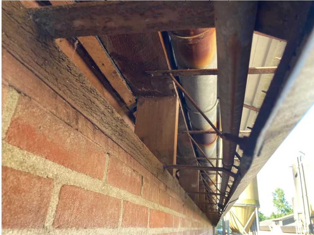
• Afbeelding 8: luchtinlaat vakensstallen (De Kampen 18)
