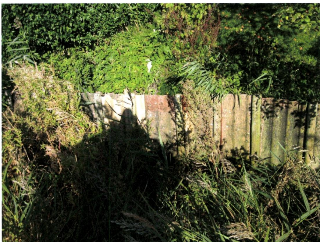
Foto 82; asbestverdachte beschoeiing sloot, zuidoostzijde perceel Oostpolder 6
