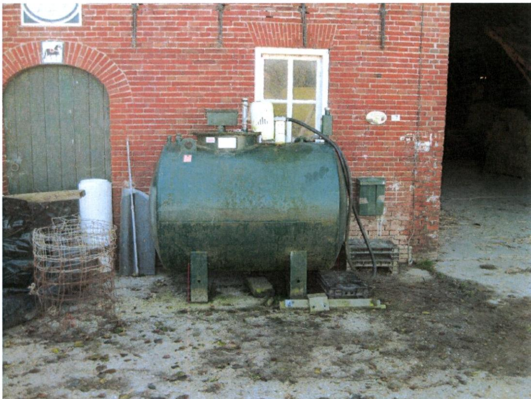
Foto 46; bovengrondse brandstoftank ten noorden van de schuur van Oostpolder 7
