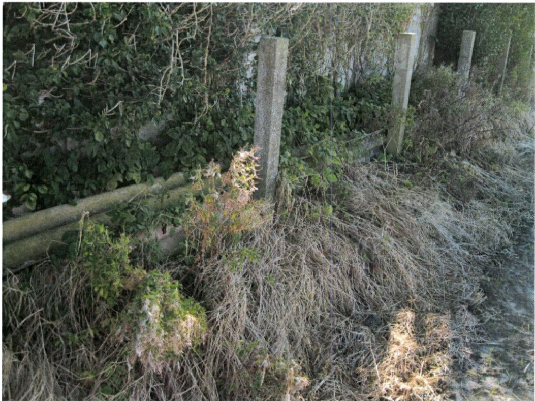
Foto 75; Asbestverdachte erfafscheiding, westzijde Oostpolder 6, in zuidoostelijke richting
