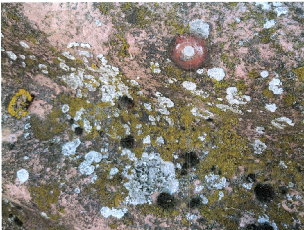
Foto 83; Detail asbestverdacht materiaal erfafscheiding Oostpolder 6
