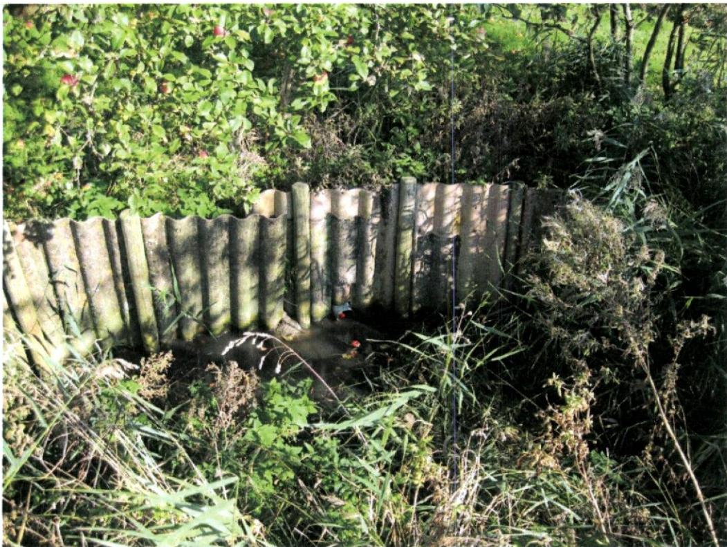
Foto 81; asbestverdachte beschoeiing sloot, zuidoostzijde perceel Oostpolder 6
