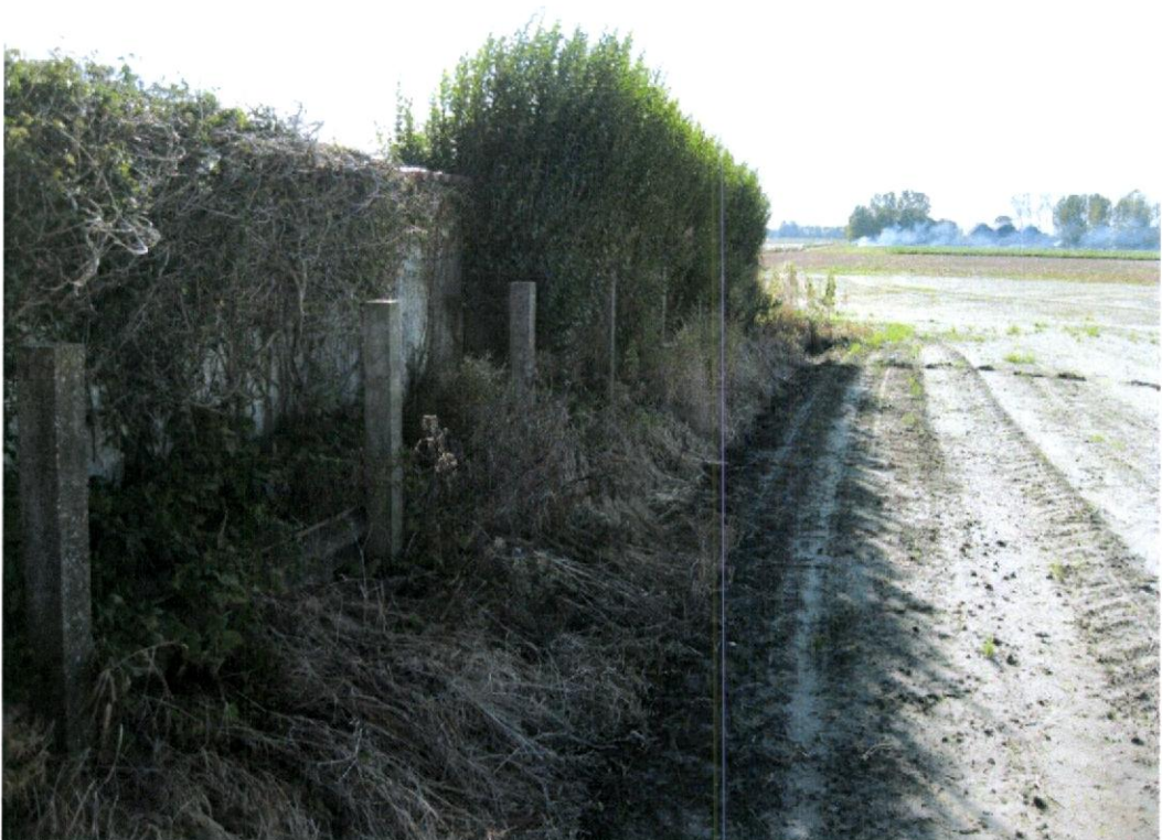
Foto 76; Asbestverdachte erfafscheiding, westzijde Oostpolder 6, in zuidelijke richting
