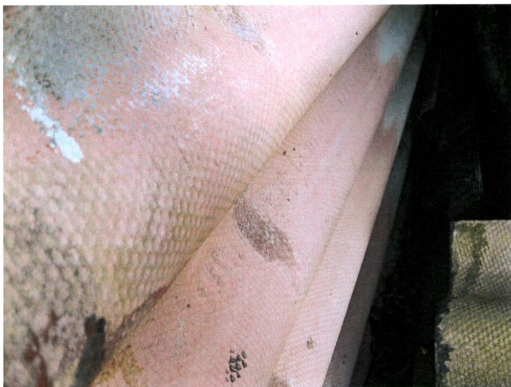
Foto 84; Detail asbestverdacht materiaal erfafscheiding Oostpolder 6
