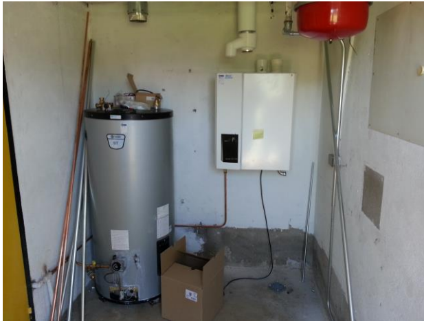
Fotonummer: FB01 De CV installatie en de boiler zijn niet asbestverdacht.
