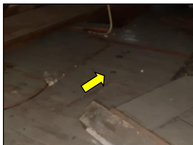
Figuur 31. Uitwerpselen steenmarter op zolder aan oostvleugel chateau.
