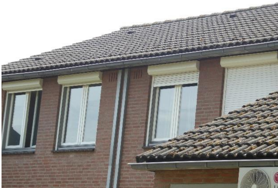
Afbeelding 24. Aangetroffen open stootvoegen en dakpannen binnen deelgebied 3.
