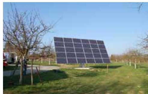
Referentie suntracker zonnepanelen
