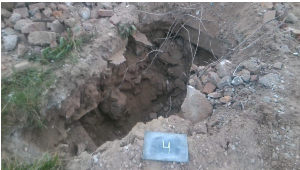
Foto 5. Asbestverdacht (plaat)-materiaal in sleuf 2
