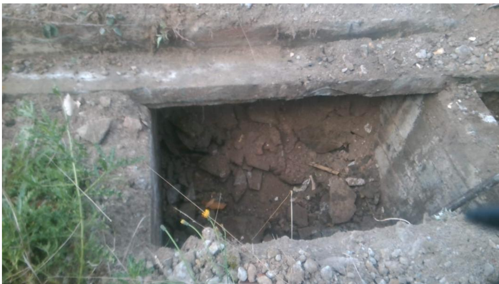
Foto 21. Grote hoeveelheid puin op het maaiveld
