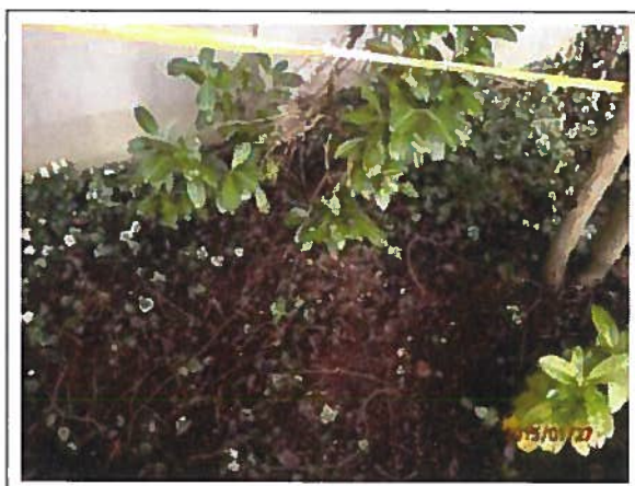
Foto 6: Begroeiing uitgesloten van inspectie
