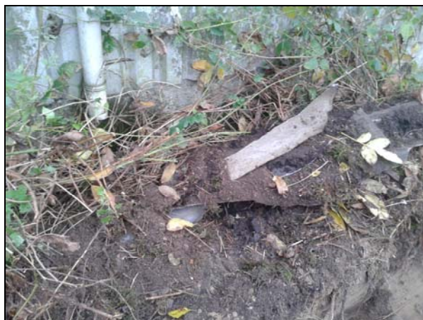
Asbestverdacht plaatmateriaal nabij sleuf 27
