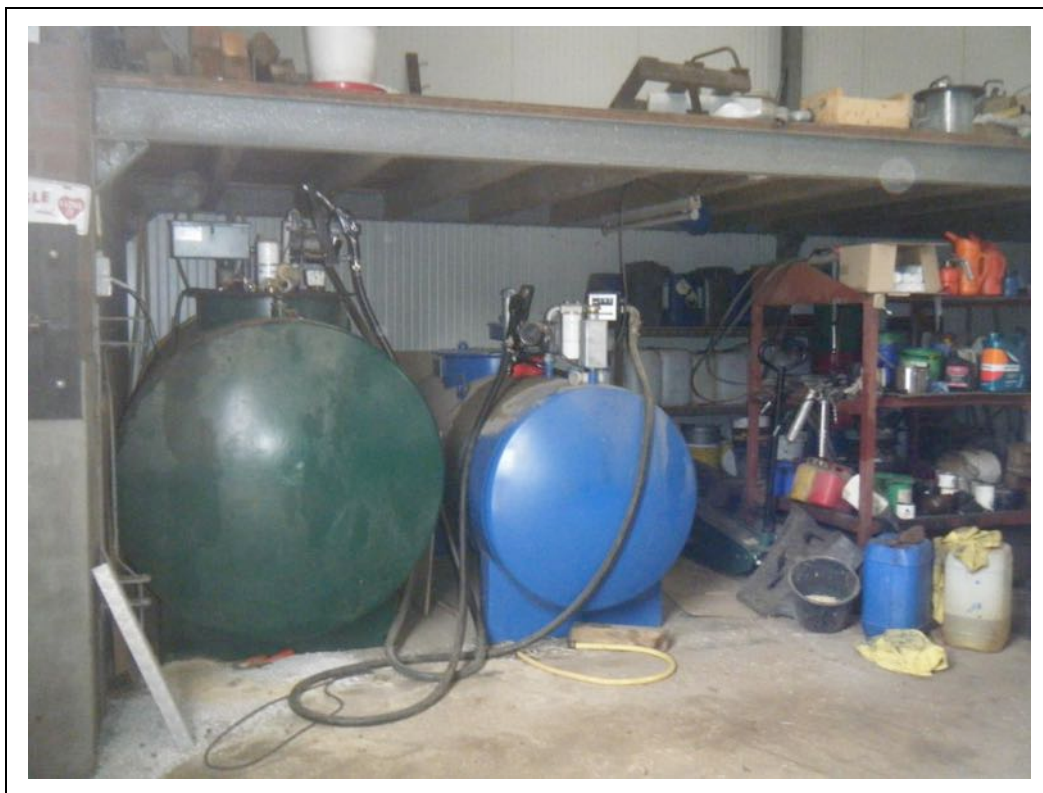
Foto 6. Dieseltanks in werkplaats/werktuigenloods (buiten onderzoekslocatie)
