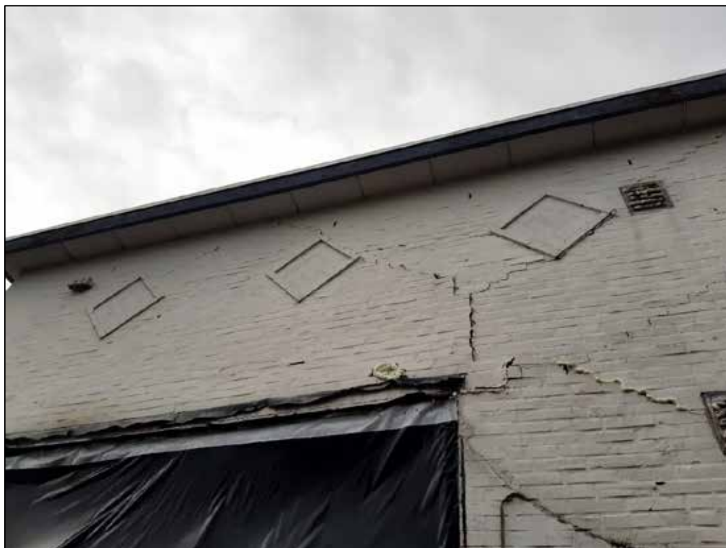
Foto 2: Zijkant van het gebouw met afgesloten stootvoegen. Verder is er ook geen ruimte onder de dakrand en tussen betonnen dakdelen. Deze waren afgedicht met bouwschuim.
