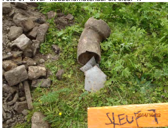
Foto 8: asbesthoudend materiaal aangetroffen ter plaatse van sleuf 7.
