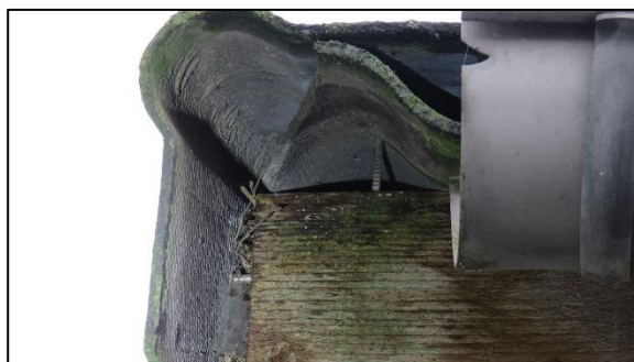
Foto 4. Opening onder de dakplaten met nestmateriaal
